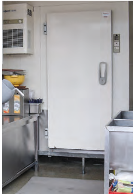
Abbildung 15: Mobile Kühlzelle mit Vorraum
